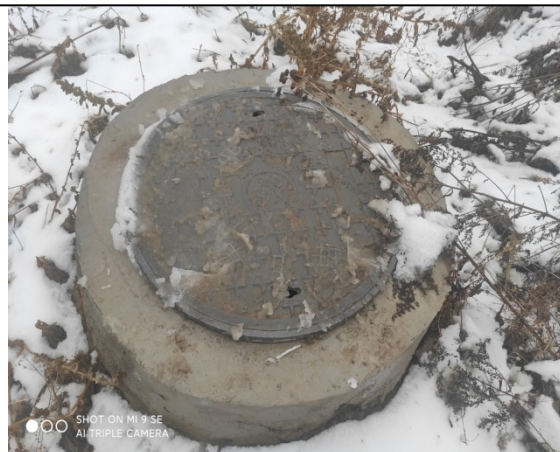
现有的化粪池
