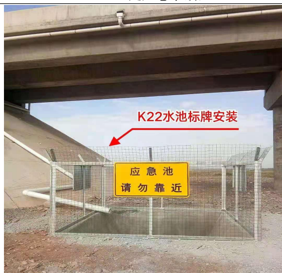
西大河大桥应急事故池 (K22+560)
